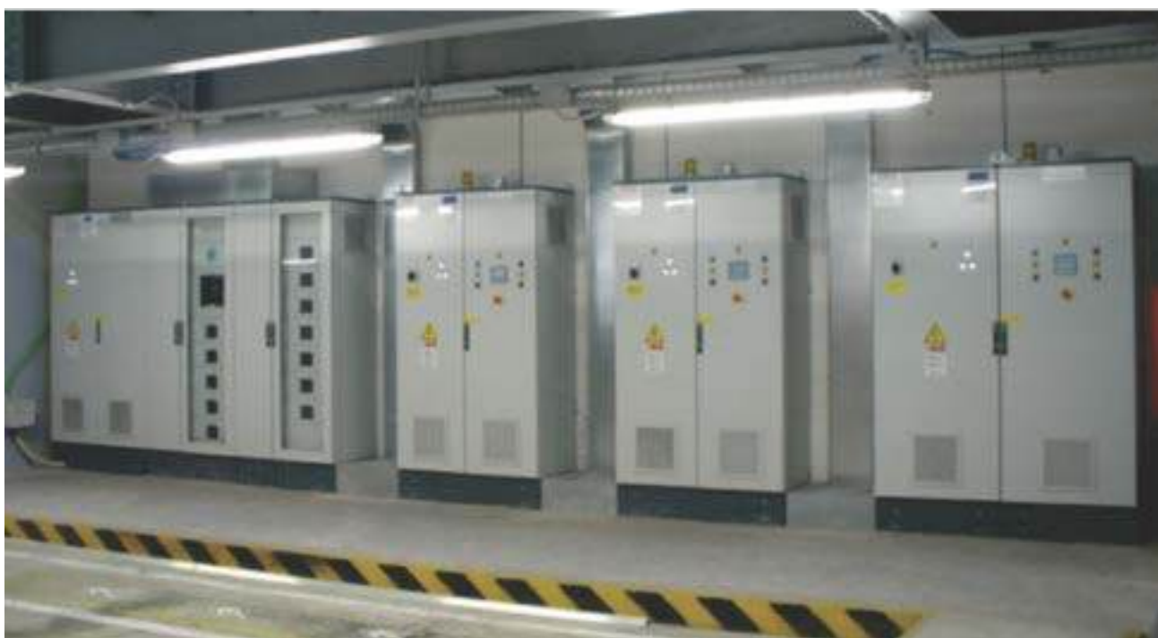
Instalado en Aeropuerto de Fiumicino NET 6000 (Roma)
