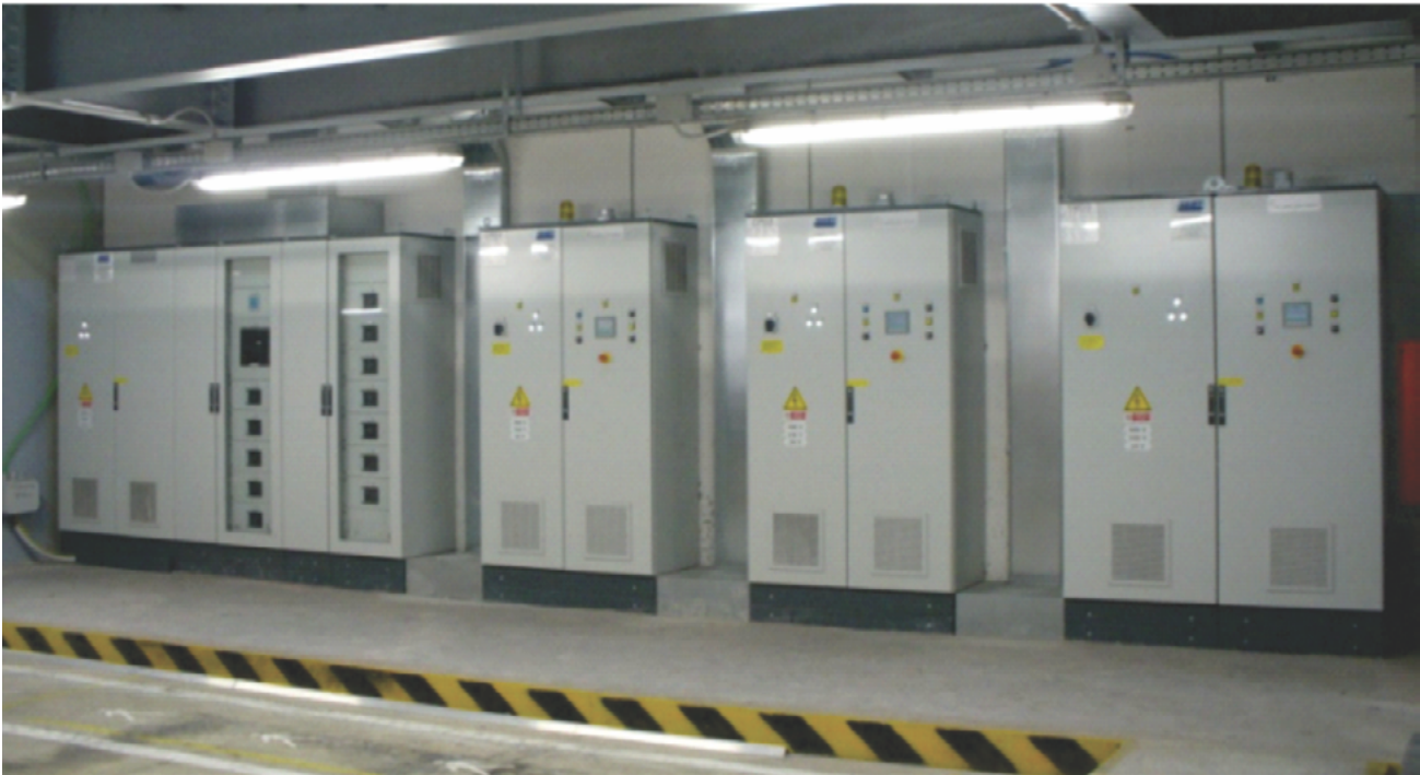
Instalado en Aeropuerto de Fiumicino NET 6000 (Roma)
