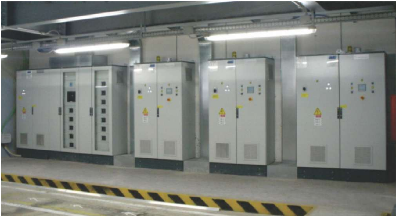
Instalado en Aeropuerto de Fiumicino NET 6000 (Roma)
